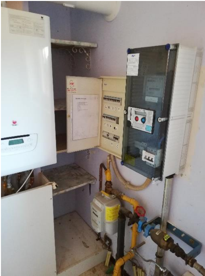
Nieuwe verwarmingsketel in de Sint-Jansstraat
